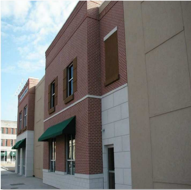
交通量が多いので、建物の低層は衝撃強度を上げるためにドライビットのインターメディアイトメッシュを2層重ねて使いました。
